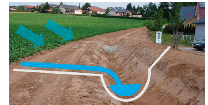
Mulden und Wälle verhindern das Eindringen von Starkregengewässern in Wohngebiete
