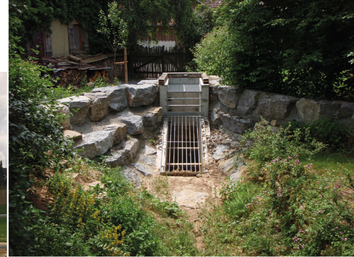
Innerörtliche Überflutungen lassen sich durch optimierte Einlaufbauwerke eindämmen (Beispiel: Einlaufbauwerk Neuenstadt)
