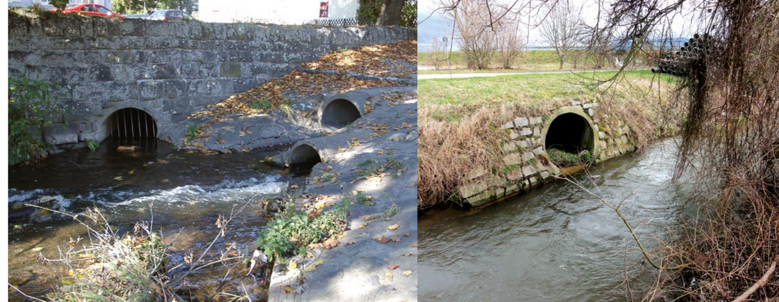
Regenwassereinleitungen in Villingen (links) und Denzlingen
