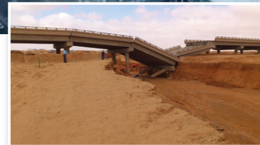
Brückeneinsturz nach Hochwasser
