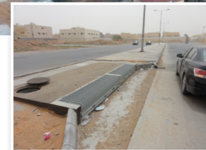
Großer Regenwassereinlauf in der Stadt
