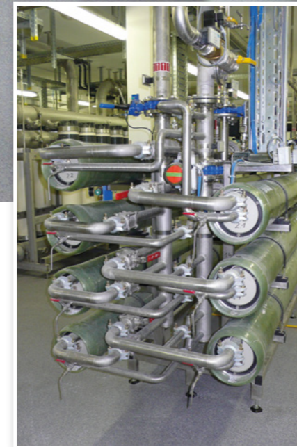
Die Investition der Stadt Sachsenheim in eine Ultrafiltrationsanlage hat sich gelohnt. Die Kommune kann weiter Eigenvorkommen nutzen, ist von Fremdwasser unabhängig und hat zudem die Trinkwasserversorgung auf Jahrzehnte sichergestellt
